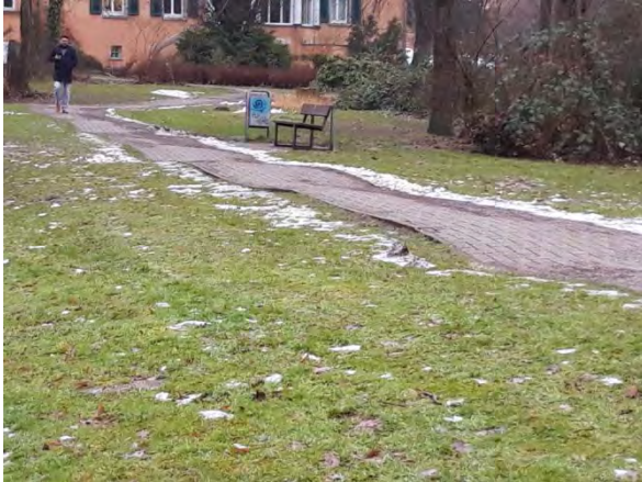
Schadhafter Wegeunterbau im Stadtpark
